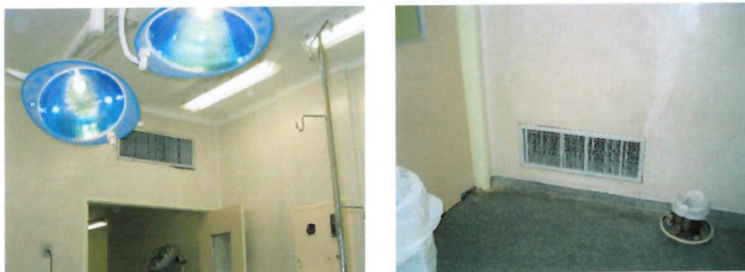
Figura 8.2.3.1. – Sistema de condicionamento de ar de sala cirúrgica do Hospital Universitário (insuflamento à esquerda e retorno à direita).
