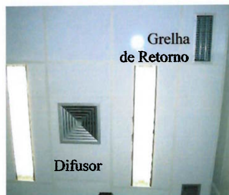
Figura 8.3.3.2. – Difusor e grelha de retorno do Laboratório de Conforto.
